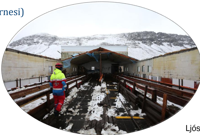
Þaklaust fjárhúsið í Vattarnesi
